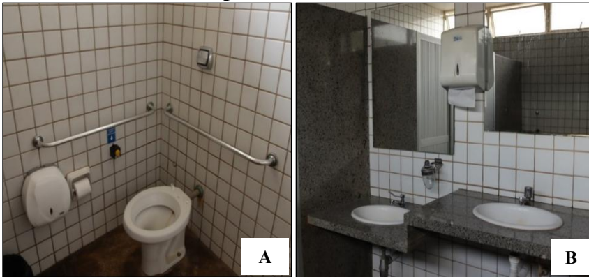
Figura 9 – Acionador de emergência, barra de apoio e lavatório rebaixado
