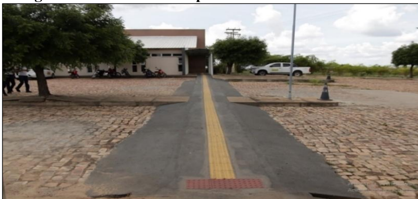
Figura 7 – Passarela com piso tátil de alerta e direcional
