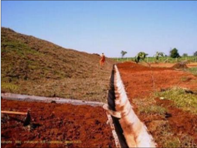
Figura 16 - Sistema de drenagem existente no aterro sanitário de Cianorte (PR)
