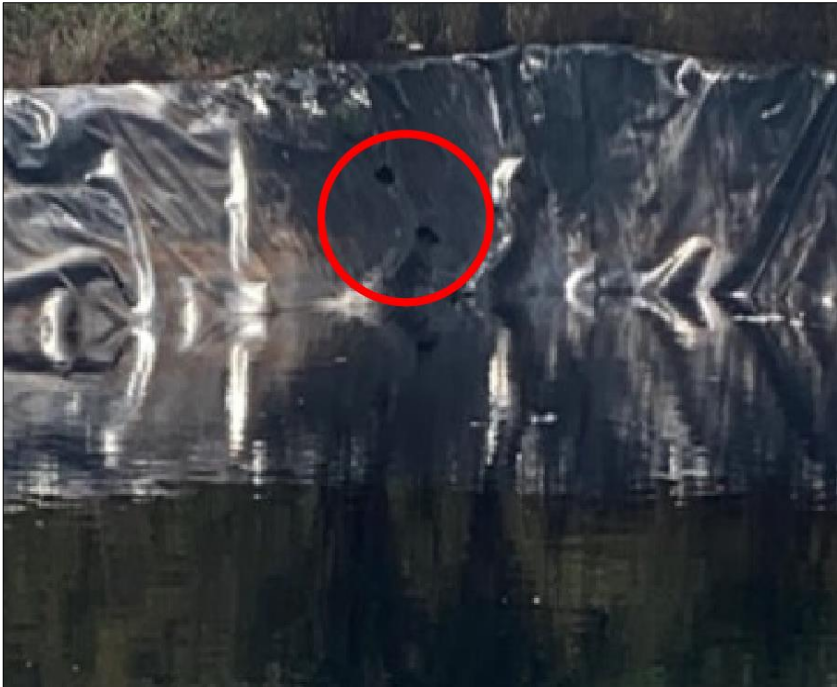
Figura 11 - Danos na geomembrana da lagoa de tratamento de chorume
