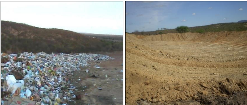
Figura 2 - Detalhe da deposição do lixo na cidade de São José do Seridó antes da implantação do AC e trincheira aberta em terreno pouco permeável para deposição e posterior cobertura do lixo
